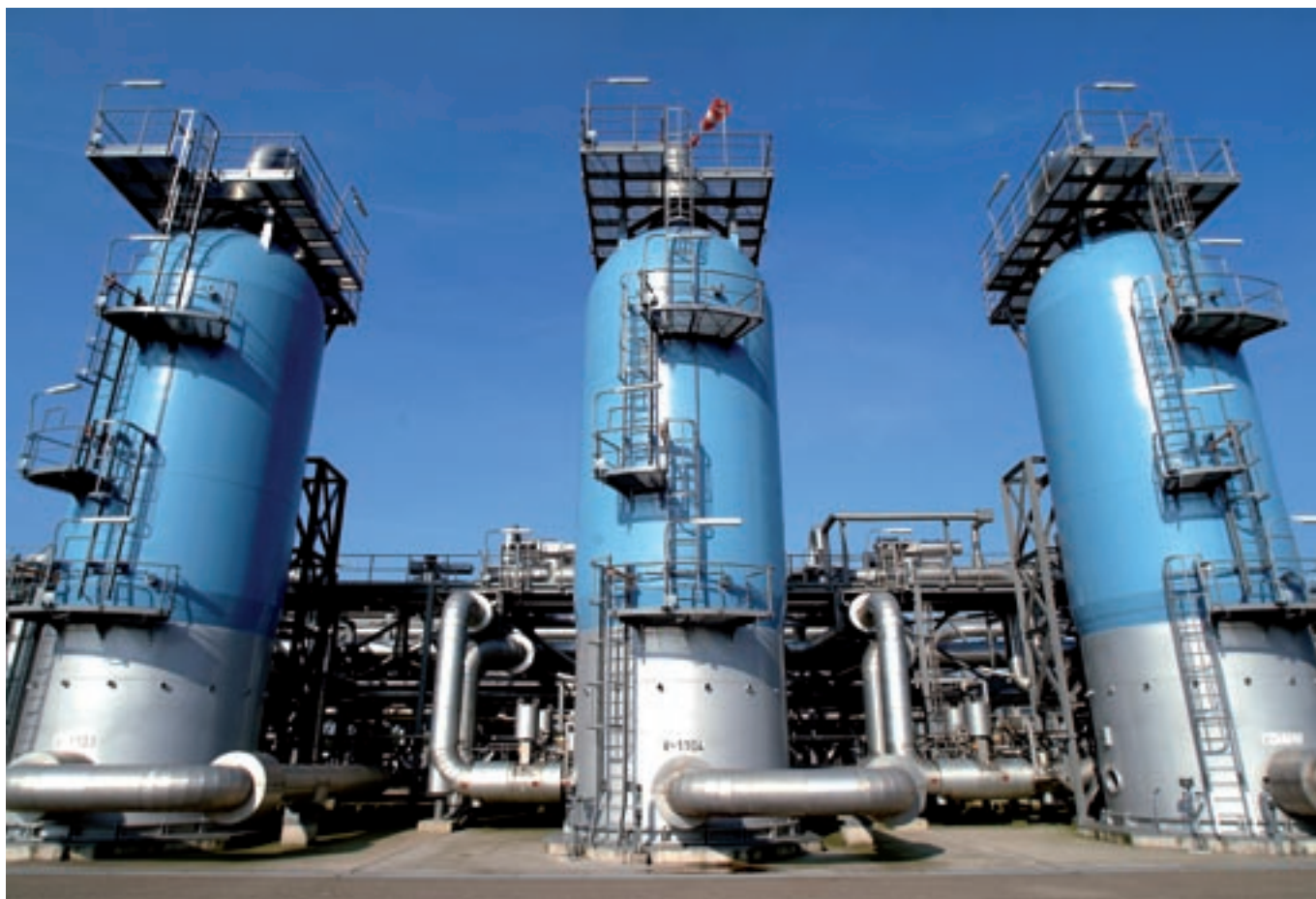
Op beide locaties staan zes adsorptietorens die elk 325.000 kilo wegen en een wanddikte van achttien centimeter hebben.
