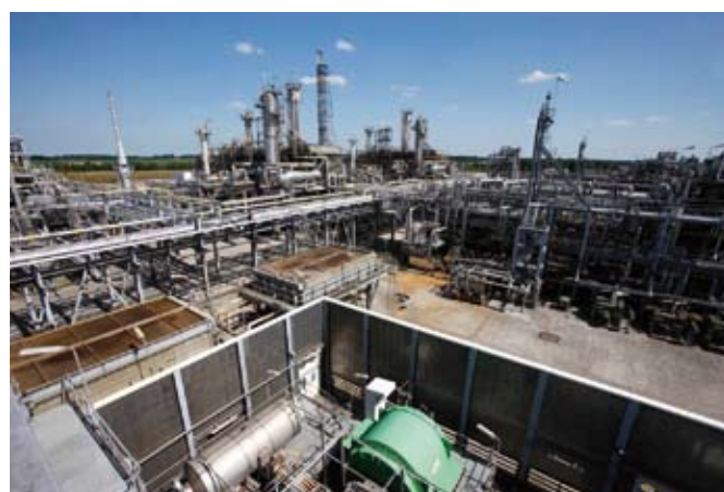
Bovenaanzicht van de compressieruimte, waar het gas op de juiste druk wordt gebracht.
